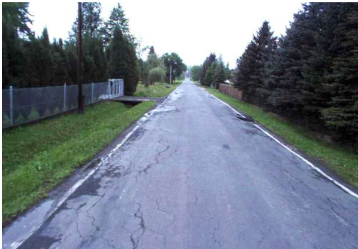
Wola Radziszowska – droga powiatowa nr 1939K przed modernizacją.
